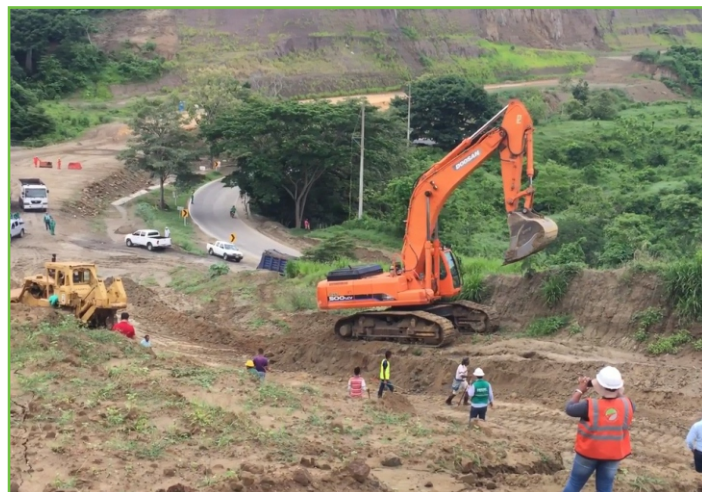
Las obras de la Segunda calzada Sincelejo - Tolviejo continúan a buen ritmo en el sector de Sierra Flor.
